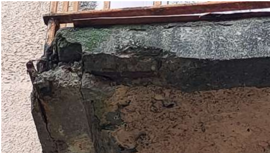
Εικόνα14. Το μπαλκόνι παρουσιάζει ενδείξεις αποκολλήσεων σκυροδέματος λόγω φθοράς και κατεστραμμένων μεταλλικών φατνωμάτων, τα οποία έχουν υποστεί κυρίως διείσδυση νερού- φωλιές χαλικών λόγω του ανεπαρκούς μείγματος.
