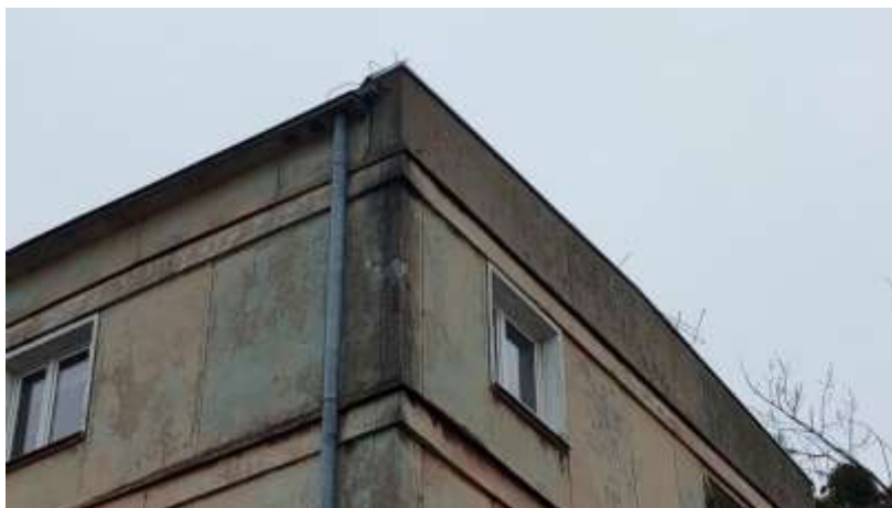
Εικόνα 12. Υγρασία λόγω καιρικών συνθηκών και ζημιές στις φλάντζες της στέγης.
