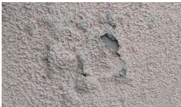
Εικόνα 3. Υποβάθμιση της δομής των παραθύρων υπογείου λόγω διείσδυσης νερού και μηχανικής δύναμης
