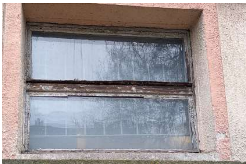
Εικόνα 9. Ένα παλιό παράθυρο σε εξαιρετικά κακή κατάσταση, με ξεφλουδισμένο χρώμα και φθορές στις μεταλλικές φλάντζες, που οφείλονται στην έλλειψη τακτικής και σωστής συντήρησης.
