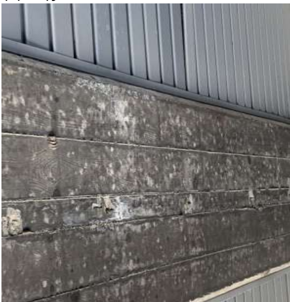
Εικόνα 5: Υγρασία επιτίθεται σε φέροντες φορείς δομές, δημιουργώντας θερμογέφυρες όπου υπάρχει αλλαγή της υλικού/δομής, που οδηγεί σε υγρομετρικές συνέπειες σε διαμερίσματα
