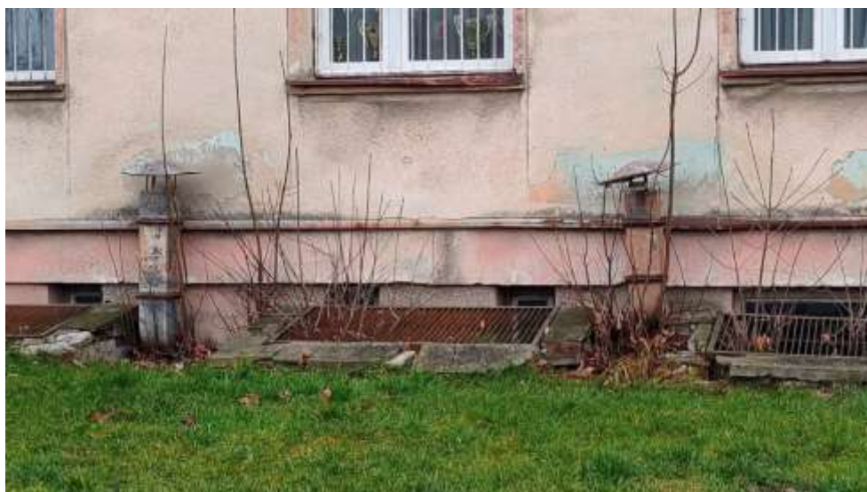
Εικόνα. 15. Το σύστημα εξαερισμού είναι απαρχαιωμένο και απαιτεί έλεγχο και αντικατάσταση.
