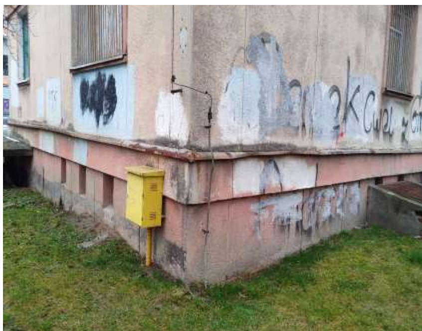
Εικόνα8. Έλλειψη εξωτερικής μόνωσης και ζημιές στις λαμαρίνες, με αποτέλεσμα προβλήματα υγρασίας εντός και εκτός του κτιρίου
