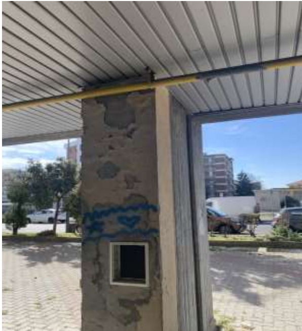
Εικόνα2: Τεχνολογική κοιλότητα προσαρμογής τοιχοποιίας που δείχνει την κατάσταση φθοράς της τοιχοποιίας
