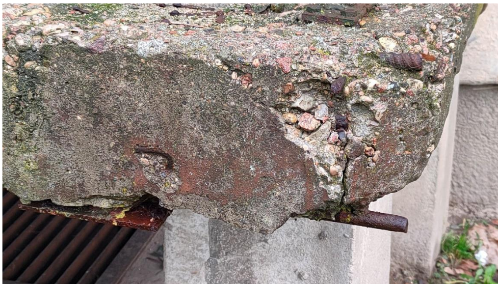
Zdjęcie 5: Platforma wejściowa z widocznymi ubytkami oraz odsłoniętym i skorodowanym żelazem zbrojeniowym
