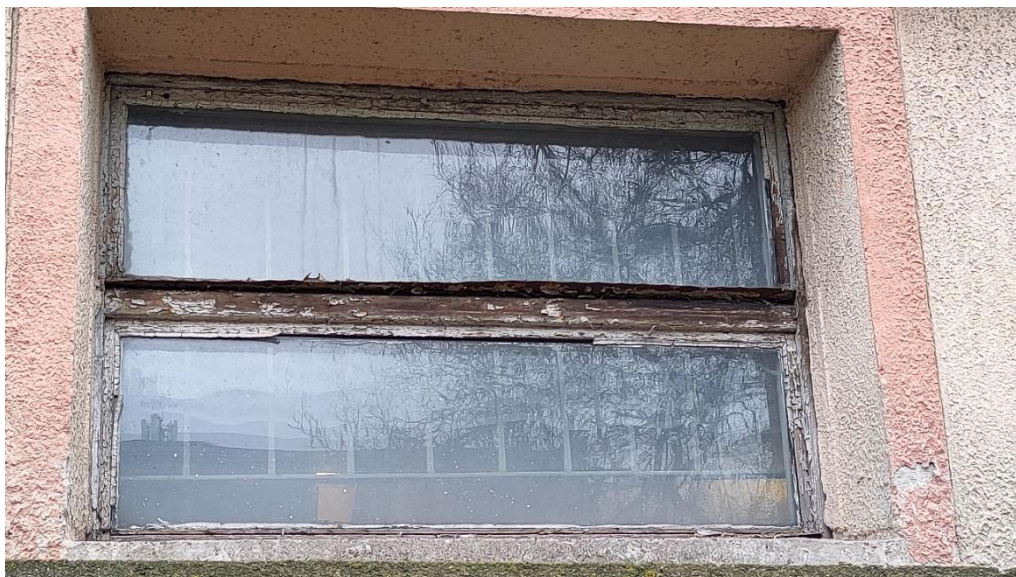
Zdjęcie 9: Stare okno w wyjątkowo złym stanie, z łuszczącą się farbą i uszkodzeniami metalowych wykończeń, a wszystko to z powodu braku regularnej i właściwej konserwacji.
