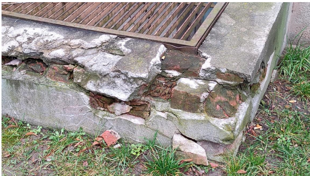
Zdjęcie 3: Degradacja konstrukcji okien piwnicznych na skutek infiltracji wody i działania sił mechanicznych
