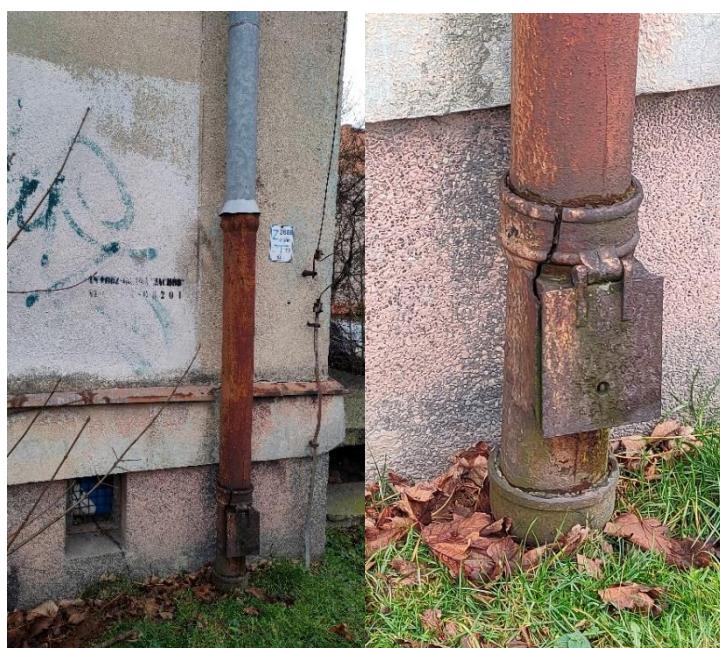
Zdjęcia 10 i 11: Uszkodzenie rury spustowej w wyniku działania mrozu lub siły mechanicznej, skutkujące zwiększoną penetracją wody przez ściany fundamentowe, a w konsekwencji - zwiększoną wilgotnością.
