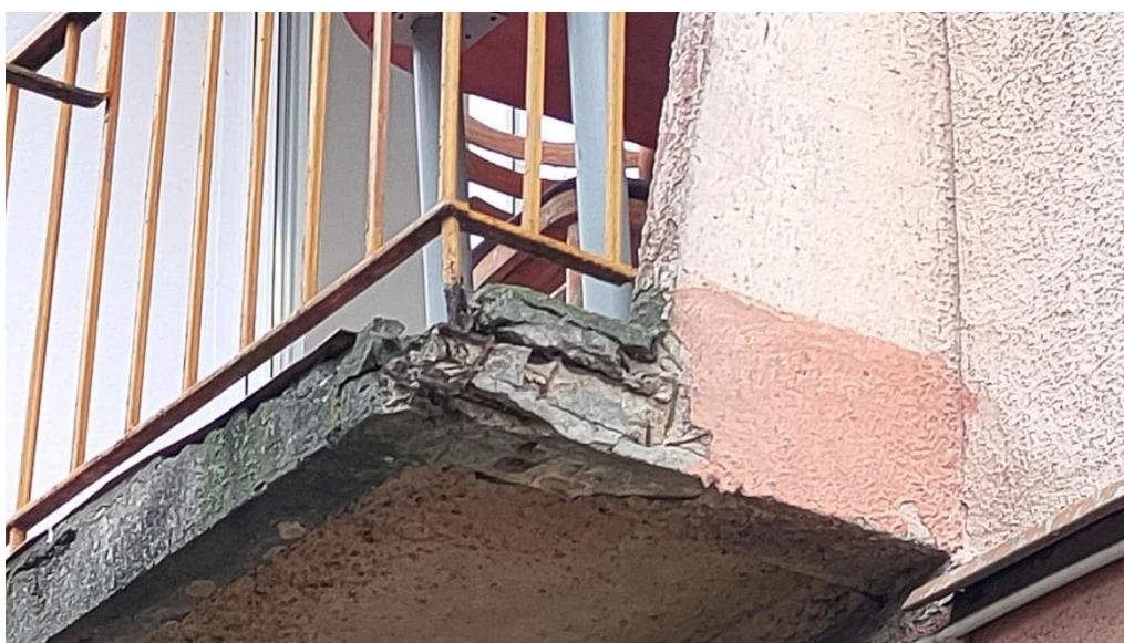
Zdjęcie 6: Pęknięcia i ubytki balkonów oraz odsłonięte i skorodowane żelazo zbrojeniowe.
