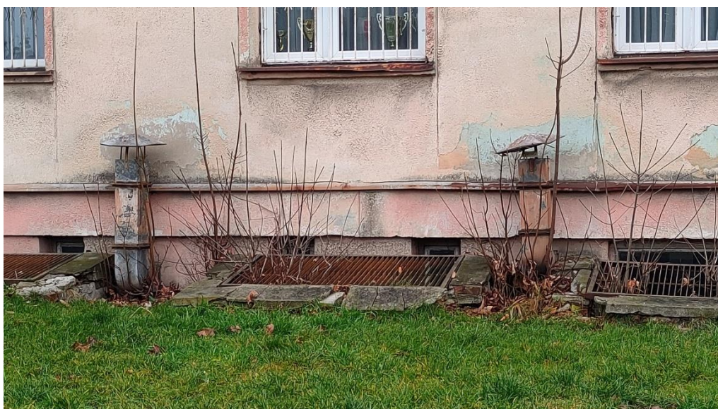
Zdjęcie 15: System wentylacji jest przestarzały i wymaga przeglądu oraz wymiany.
