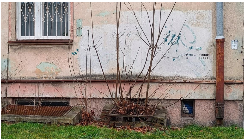
Zdjęcie 13: Samosiejki drzew i krzewów niszczące konstrukcje murowanych okien piwnicznych i umożliwiające penetrację wody w głąb murów.
