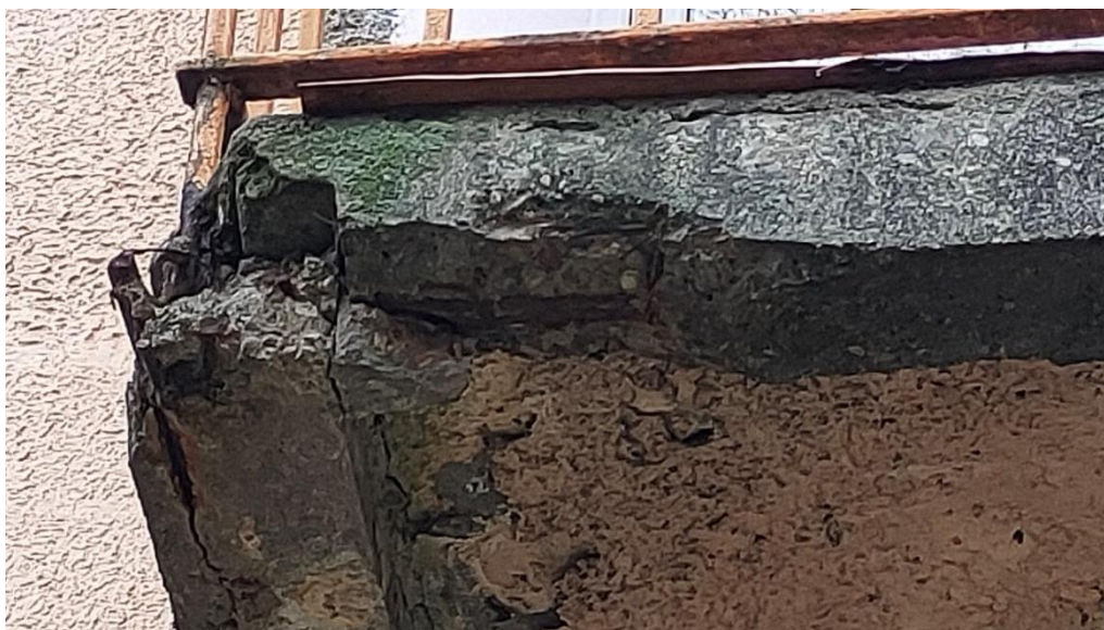
Zdjęcie 14: Na balkonie widoczne są ślady odspojenia betonu na skutek zużycia oraz uszkodzone metalowe obróbki blacharskie, w większości narażone na infiltrację wody; gniazda żwirowe na skutek nieodpowiedniej mieszanki.
