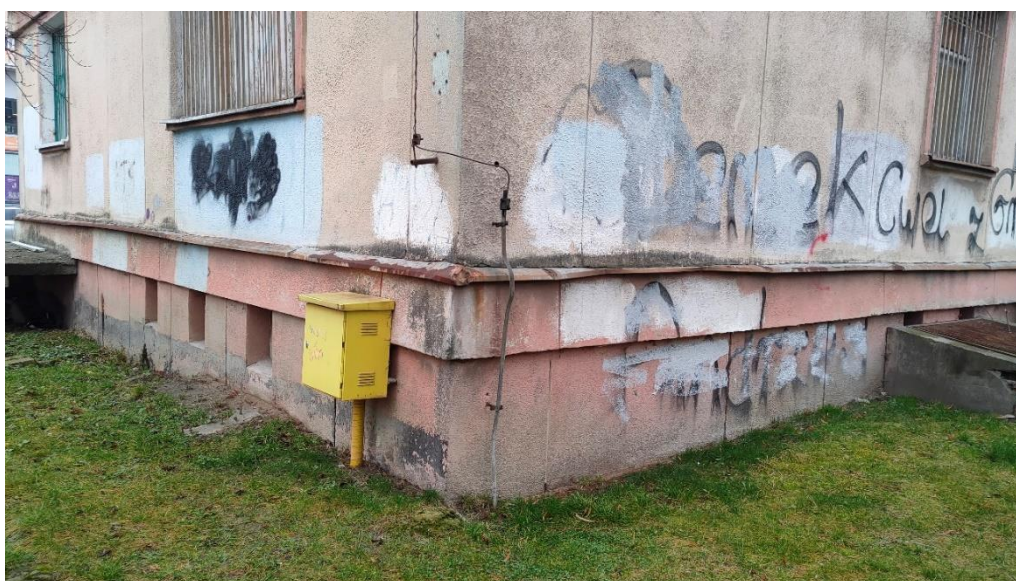
Zdjęcie 8: Brak izolacji zewnętrznej i uszkodzenia obróbek blacharskich, co powoduje problemy z wilgocią wewnątrz i na zewnątrz budynku.
