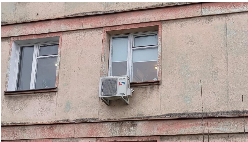
Zdjęcie 2: Indywidualne urządzenie klimatyzacyjne (typu split).
