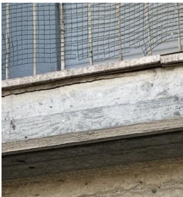
Zdjęcie 10: Belki odrywają się od pokryć tarasowych z powodu mostków cieplnych.
