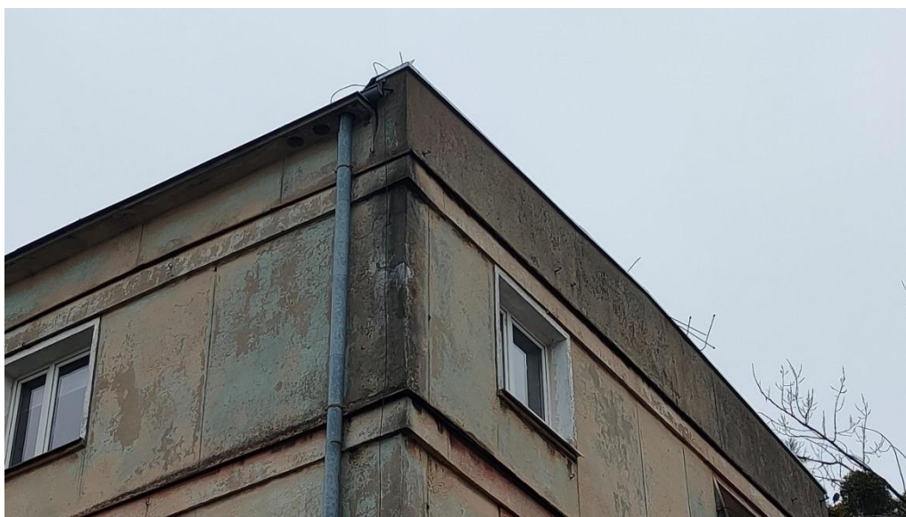
Zdjęcie 12: Wilgoć spowodowana warunkami atmosferycznymi i ubytkami obróbek.
