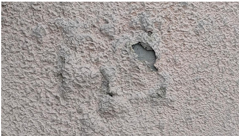
Zdjęcie 4: Zniszczenia tynku ścian zewnętrznych z powodu jego cienkiej warstwy oraz wilgoci.
