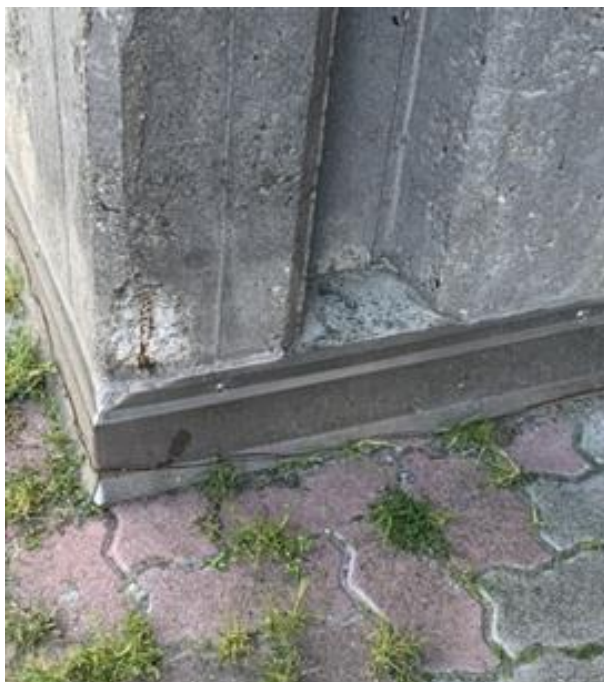
Zdjęcie 5: Na filarze widoczne ubytki z powodu zbyt cienkiej osłony, która jest przyczyną pęknięcia żelaza.
