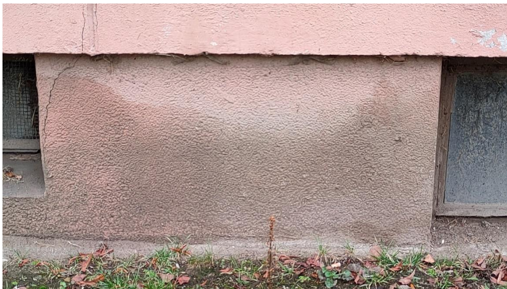
Zdjęcie 7: Betonowa ściana fundamentowa wykazuje widoczne oznaki obecności wilgoci.
