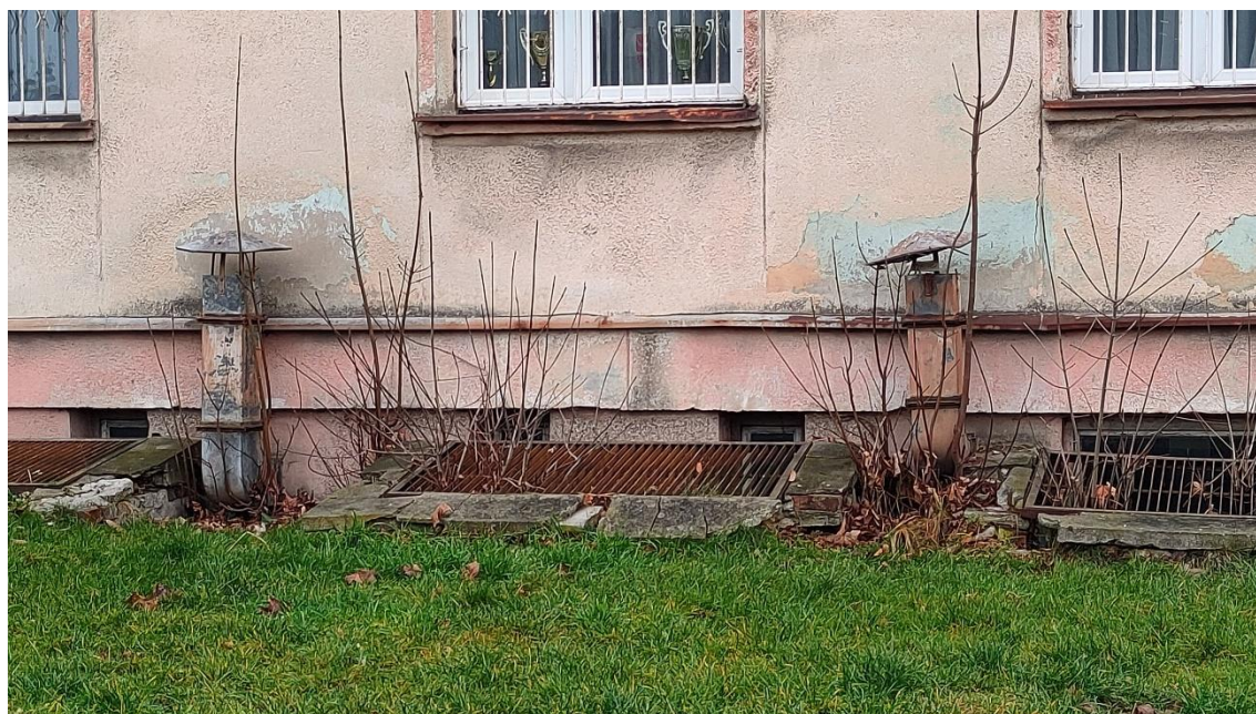
Foto 15. Ventilatsioonisüsteem on vananenud ja vajab auditit ja väljavahetamist.
