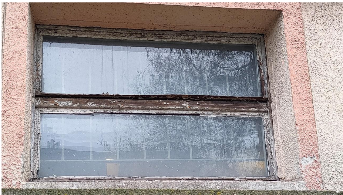
Foto 9. Äärmiselt halvas seisukorras vana aken, millel on koorunud värv ja kahjustused veeplekkidel, mis kõik tingitud korrapärase ja korraliku hoolduse puudumisest.
