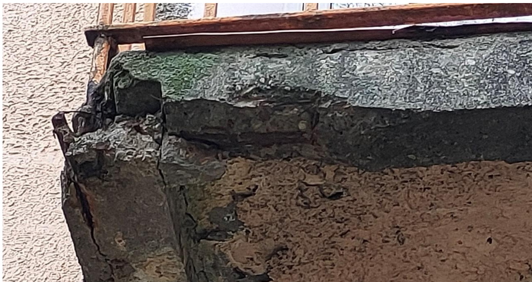
Foto 14. Rõdul on näha lagunemisest tingitud betooni ärakukkumisti ja korrodeerunud metallist piirdeid, mis on enamasti tingitud vee imbumisest betoonkonstruktsioonidesse, upesade eraldumised vale segust vtulenevalt.
